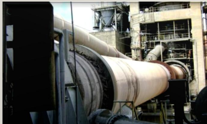
Coprocessamento em Forno de Cimento
