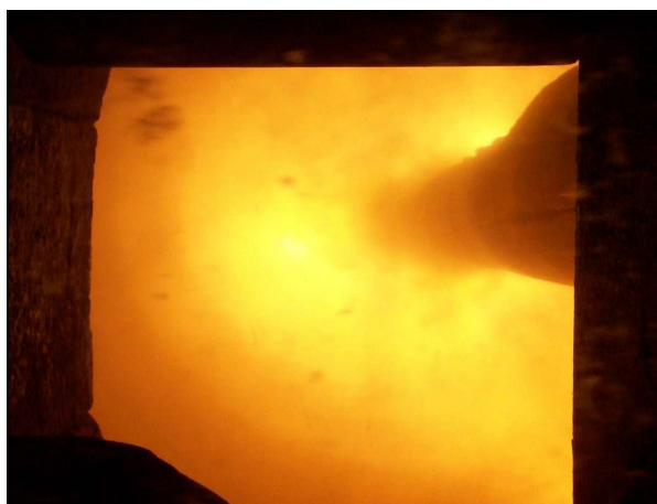
Figura 3 – Vista parcial da zona de queima primária de um forno de clínquer com resfriador de satélites
