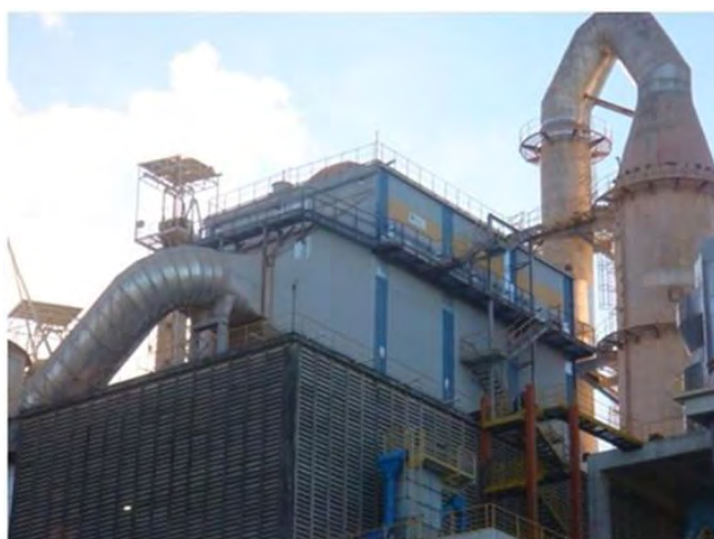
Figura 37: Filtro de mangas - moagem de cru/forno
