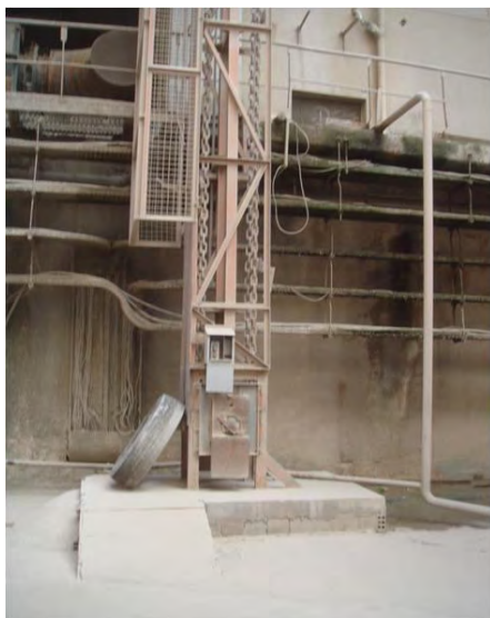
Figura 21: Elevador para dosagem de pneus inteiros
