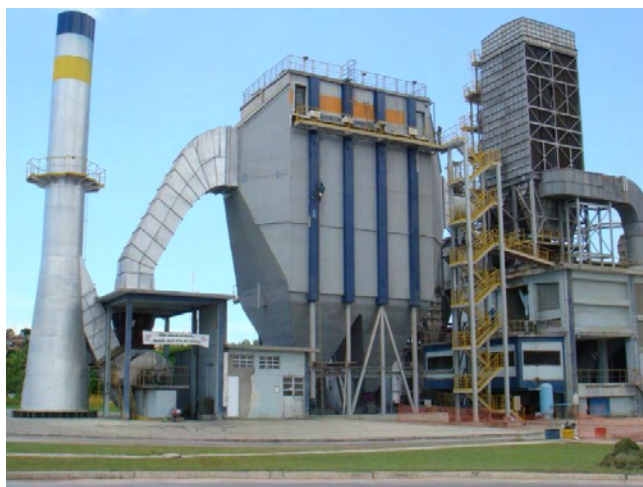
Figura 36: Filtro de mangas - resfriador de clínquer
